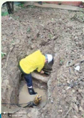
居民小區處理水堵
