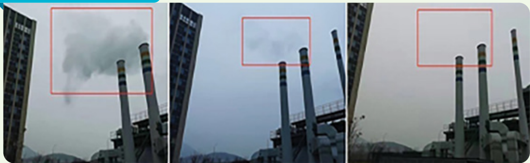
改造前（濃煙拖尾35m）
